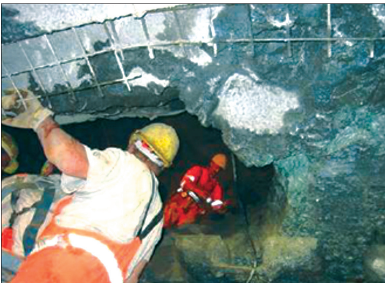
Fot. 24 - Resultado de um colapso na abóbada de um túnel durante a escavação (Fonte: Gomes, 2012).
