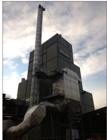
Fot. 4 - Central de pirólise de produção de eletricidade, processamento de vapor e óleo a partir de biomassa lenhosa. Hengelo, Holanda (08/11/2016).
