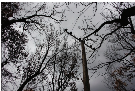
Fot. 6 - Aspeto do poste de eletricidade, rodeado por sobreiros, alguns deles com as pontas a roçar os fios, onde teve início o incêndio das Regadas (Fonte: Arquivo da Diretoria do Centro da Polícia Judiciária).
