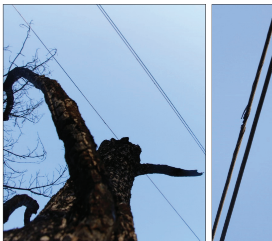
Fot. 1 - Vista dos cabos condutores sobre o carvalho, à esquerda, e pormenor dos danos causados num desses cabos, à direita (Fonte: Arquivo da Diretoria do Centro da Polícia Judiciária).
