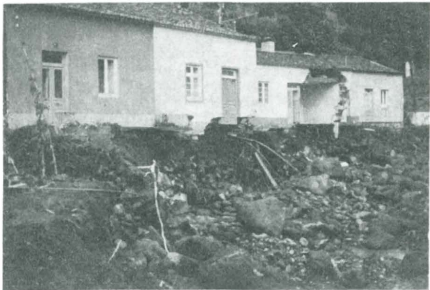
FOR. 6 — Consequências do trabalho de sapa em margem côncava. V. localização na Fig. 4 — a estrada desaparece pela acção das águas.
