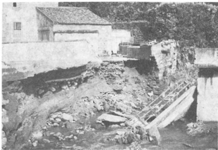
FOR. 4 — Consequências do trabalho de sapa das águas na margem direita da ribeira dos Lagos (Povoação). V. localização na Fig. 3.
