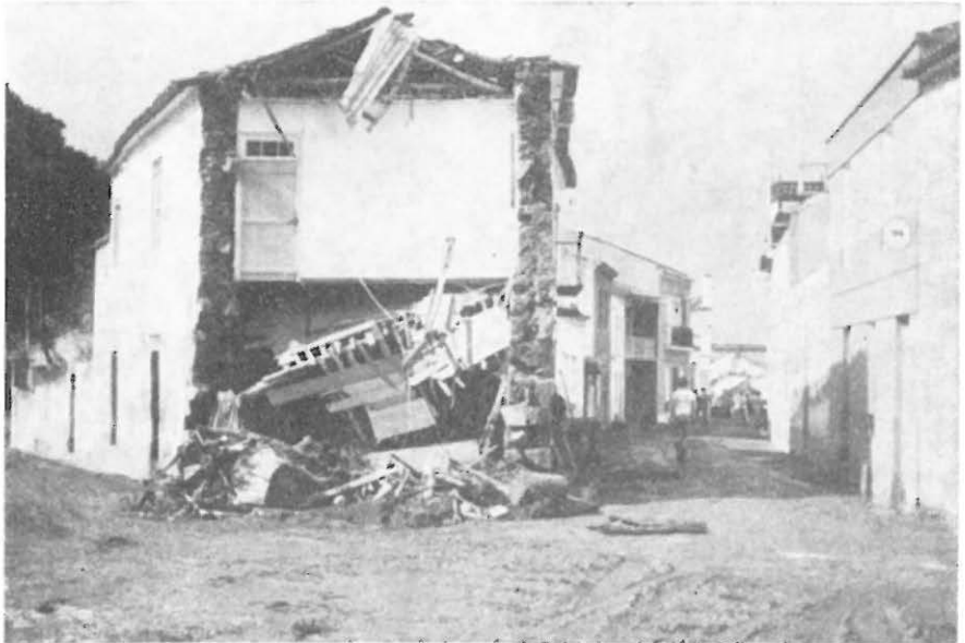
FOT. 2 — Casa destruída pelas águas na Povoação. V. localização na Fig. 3.
