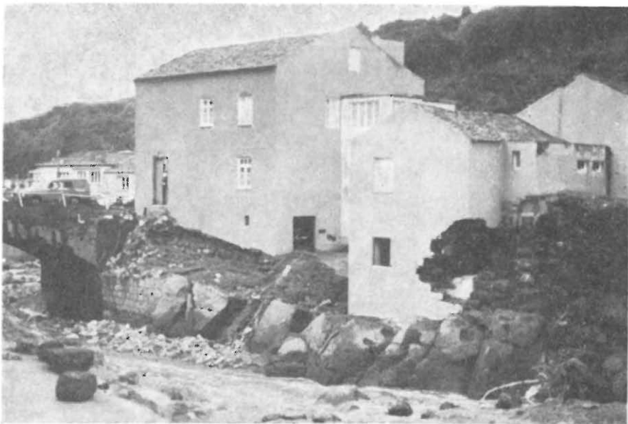
FOR. 3 — Consequências do trabalho de sapa das águas na margem direita da ribeira do Purgar (Povoação). V. localização na Fig. 3.
