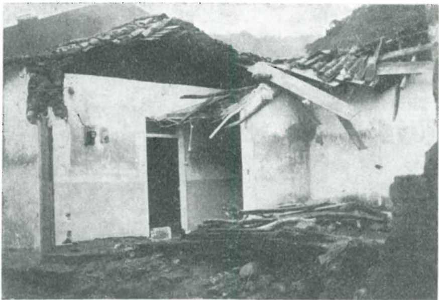
FOR. 5 — Casa destruída pelas águas no Faial da Terra. V. localização na Fig. 4 — a Rua dos Álamos ficou transformada em ribeira caudalosa.
