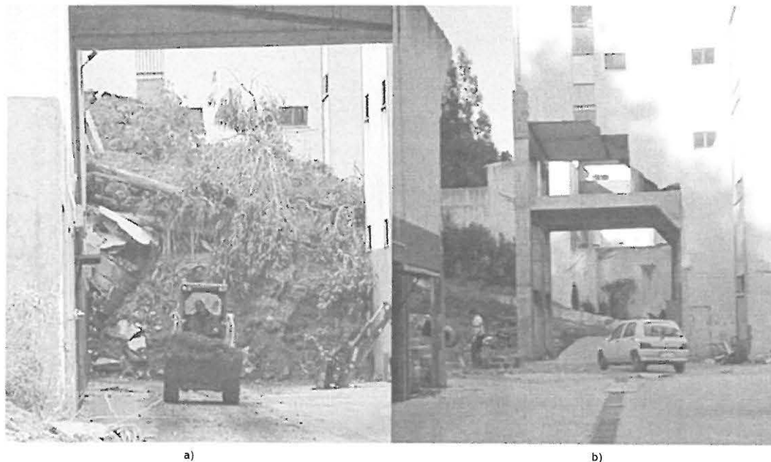
Figura 13 Danos no edifício e garagens na Av. Elísio de Moura: a) no dia seguinte à instabilização (28 de Dezembro de 2000); b) após a reabilitação da estrutura, decorrido um ano.
