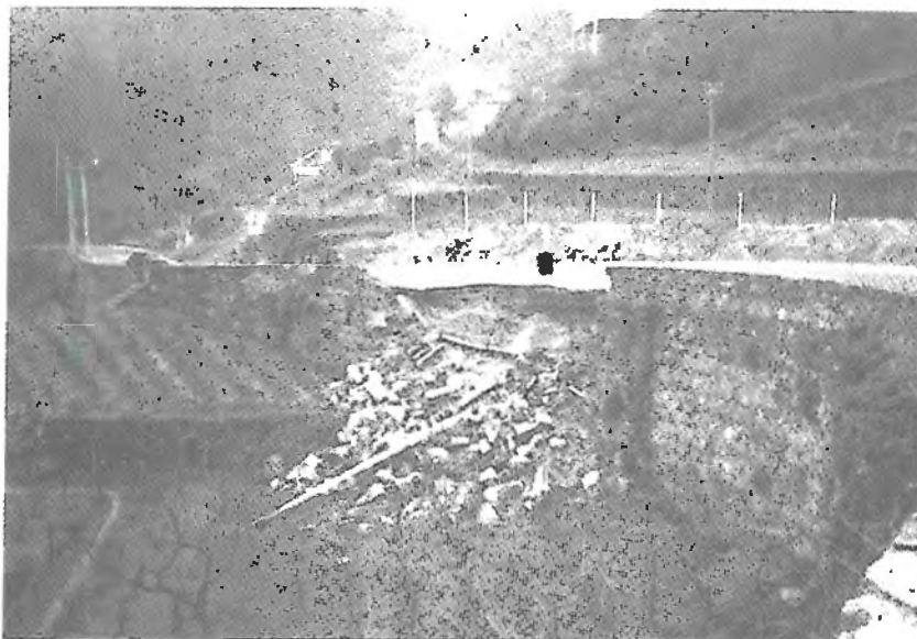
Fot. 4 - Desmoronamento ocorrido na EN 2 perto de Cumieira na sequência dos temporais de Dezembro de 1989.
