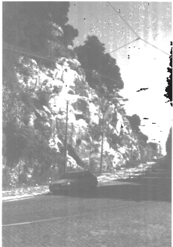
Fot. 6 - Parede granítica da Rua da Restauração (Porto). Devido às numerosas juntas (fracturas e diáclases) do granito, a pressão das raízes de algumas árvores, de solos e águas de escorrência, certamente em ligação com o trânsito abundante, fizeram com que esta parede, talhada quase na vertical, apesar de muito antiga, sofresse recentemente vários desabamentos. Enquanto não forem executadas obras de consolidação, é grande o risco de ocorrência de novos desabamentos.
