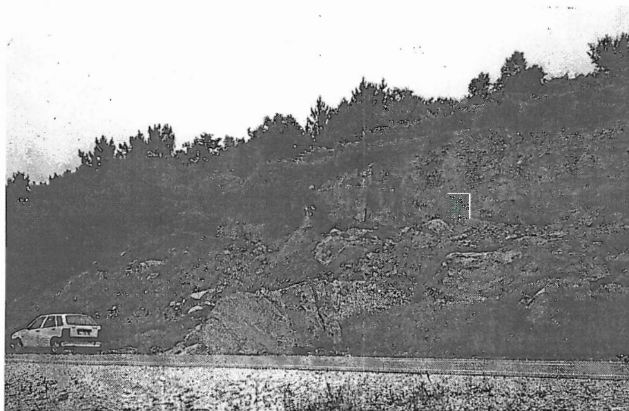
Fot. 1 - Desabamento de blocos com dimensão decamétrica na E.N. 342.
