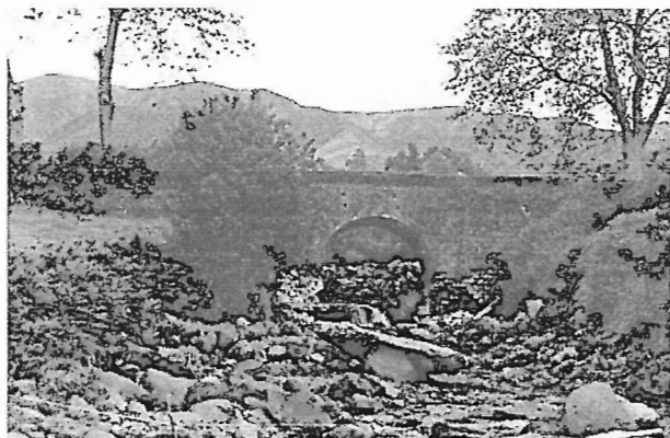
Fot. 14 - Ponte com alicerces afectados pela erosão fluvial . A montante da ponte, em 14 de Dezembro de 1996, processou-se a acumulação de cerca de 2 m de sedimentos.
