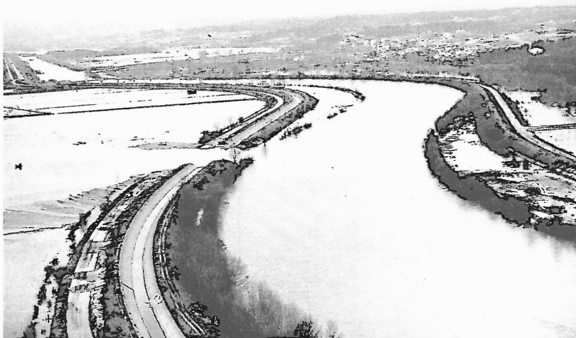
Foto 14 – Panorâmica da ruptura no dique direito do Canal Principal, junto de Santo Varão (foto de A. Carriço, 30/01/2001), permitindo observar o contorno do derrame de areia.
