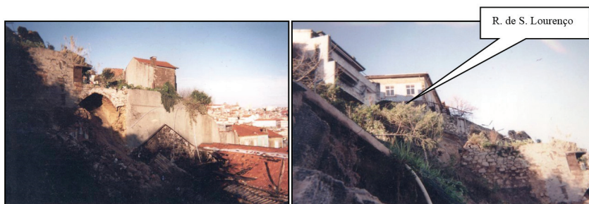
Fot. 6 e 7 - Mostrando a derrocada e evidenciando as habitações em risco de ruir (J. G. Guimarães, Jan. 2001).
