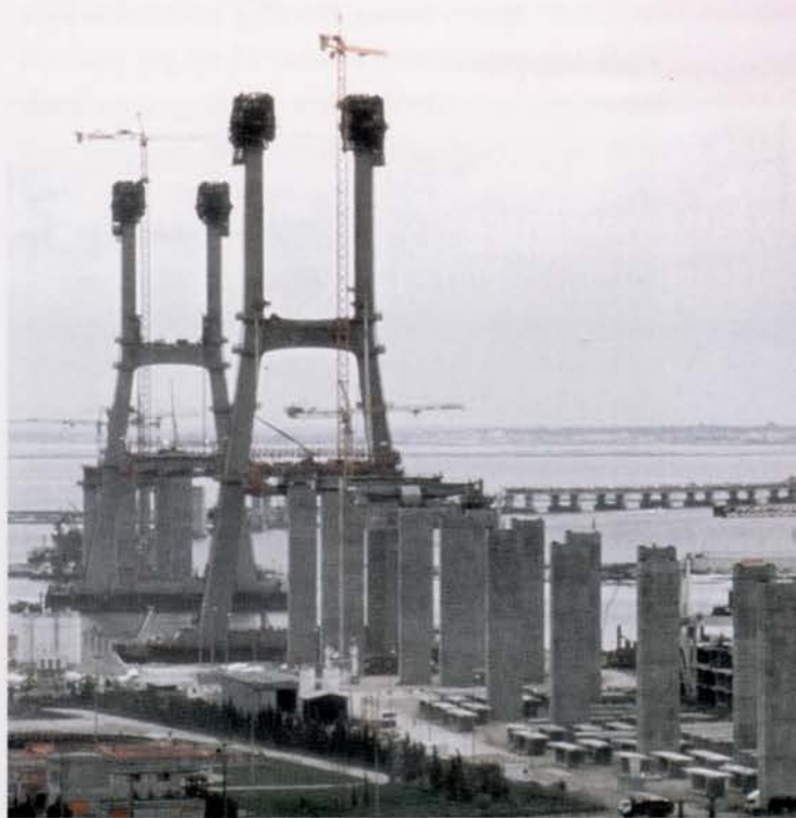
Viaduto Expo e ponte principal. Em primeiro plano vê-se os pilares do viaduto Expo e ao fundo as torres da ponte principal Expo viaduct and main bridge. Piers of the Expo viaduct in the foreground and main bridge towers in the background
