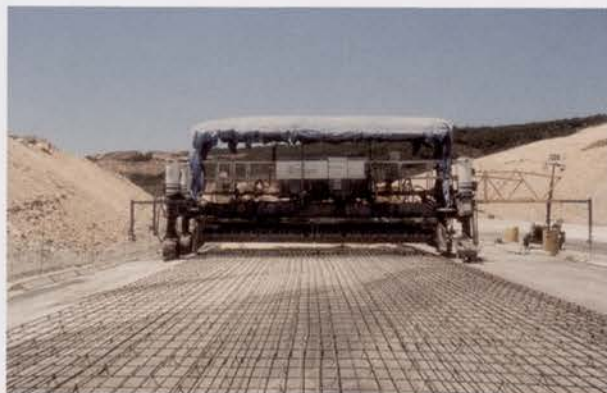
Execução do pavimento. Troço Torres Vedras-Bombarral, do IC 1 Laying pavement. Torres Vedras-Bombarral section of IC 1
