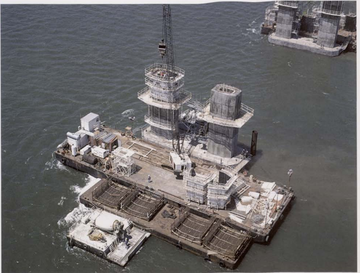
Vigas-caixão do módulo estrutural do viaduto central Box girders from the structural module of the Central viaduct
