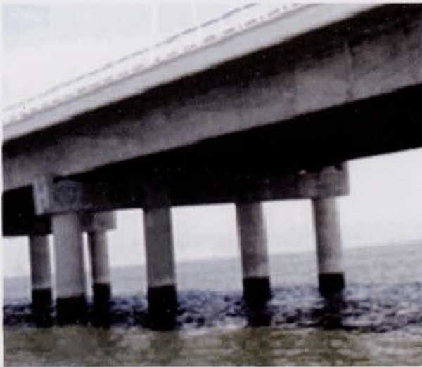
Controlo da degradação dos elementos de betão e aço em ambiente marinho Degradation control for concrete and steel elements in a maritime environment
