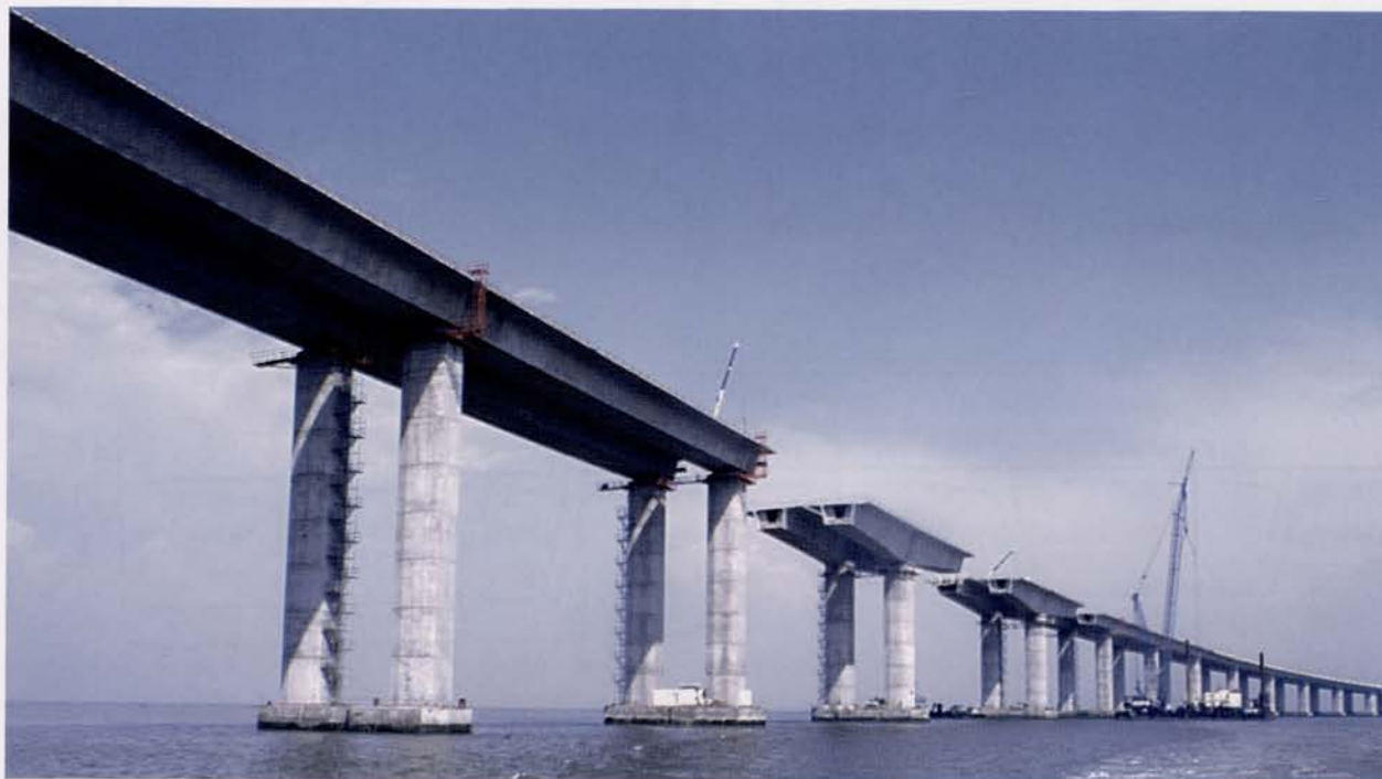
Viaduto central. Cala das Barcas e montagem de aduelas Central viaduct. Cala das Barcas and installation of arches
