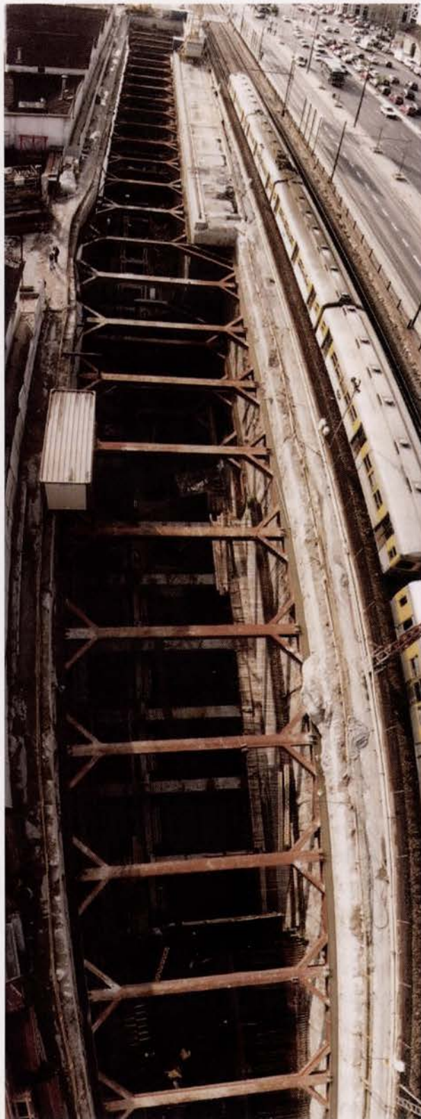
Vista da escavação para a construção do término do Cais do Sodré Excavation view for the construction of "Cais do Sodré" terminus
