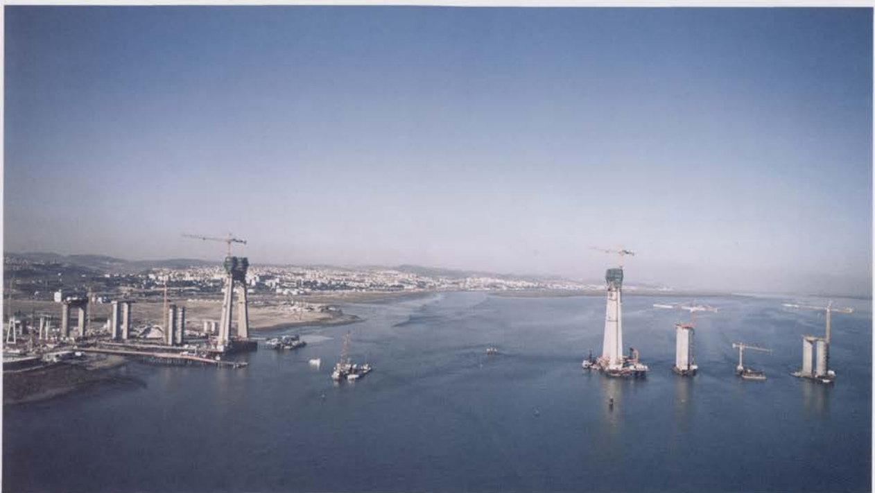
Ponte principal, vista geral da construção das torres e dos pilares dos vãos laterais Main bridge, general view of tower construction and piers for lateral spans
