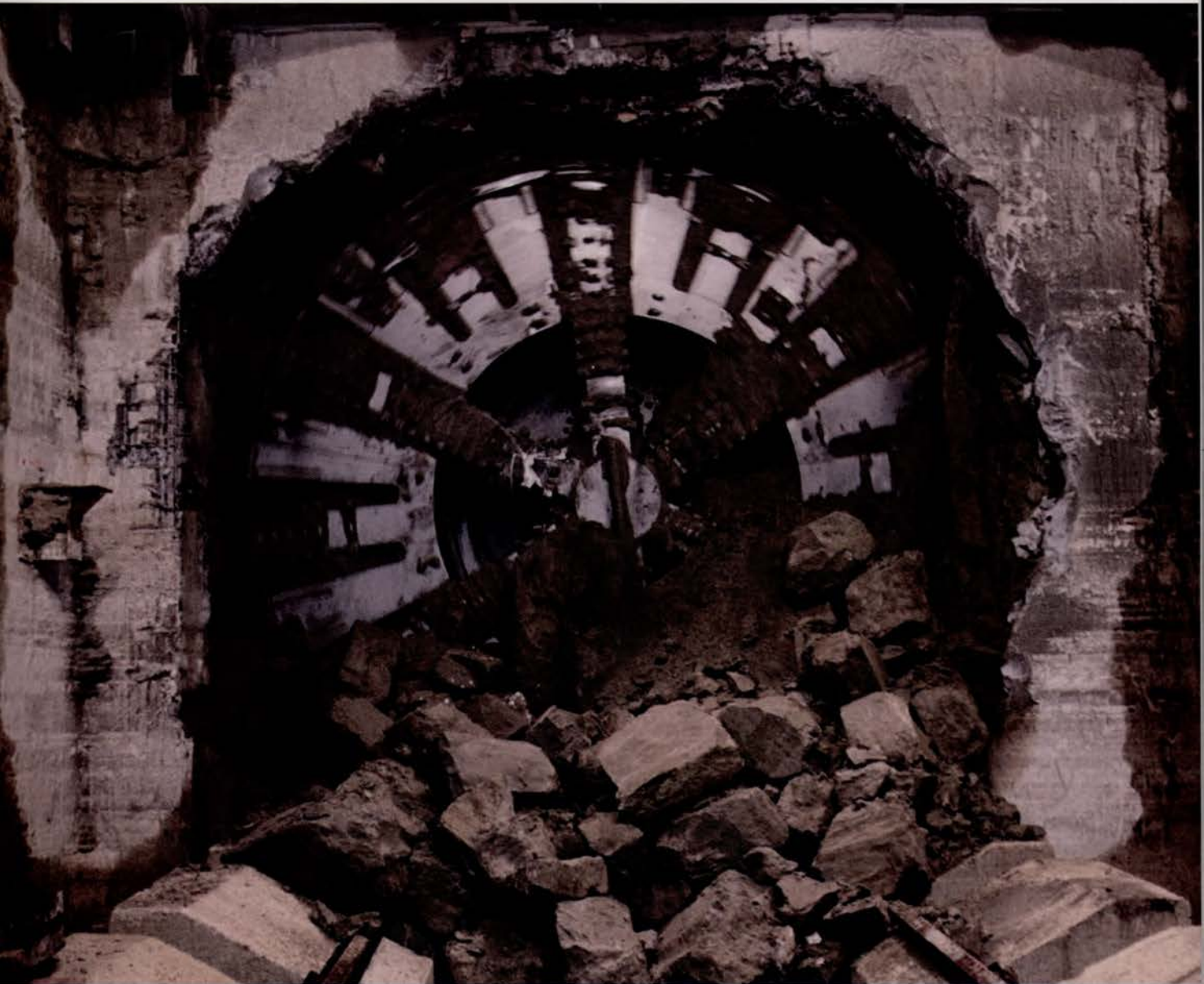
Escudo em escavação para a chegada ao poço do Rossio Shield in excavation to reach Rossio shaft
