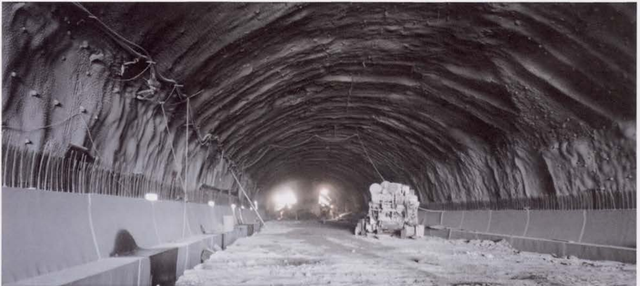
Interior do túnel sul, execução da parte inferior do revestimento da secção escavada Interior of south tunnel, construction of lower lining for excavated section
