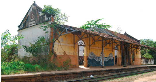
Fig. 5 - Estação Ferroviária Tibiriça, degradada por abandono (Sérgio Losnak, 27/08/2014).
