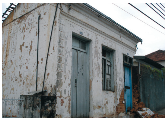
Fig.1 - Casa dos Pioneiros, contendo degradação estrutural (Sérgio Losnak, 22/08/2014).
