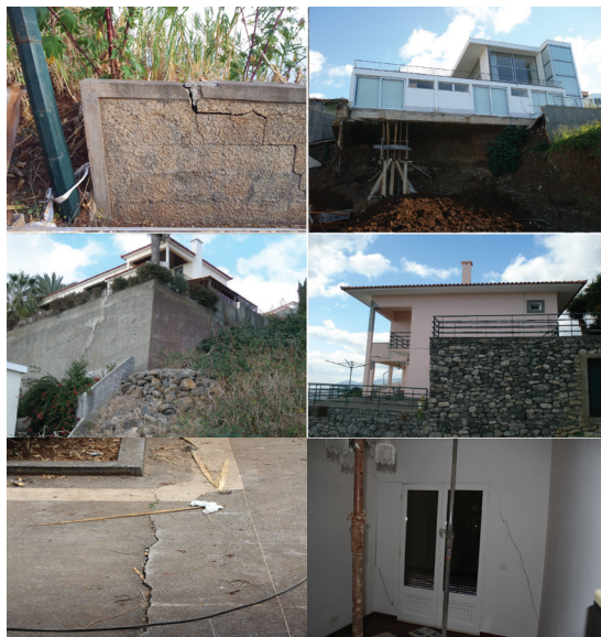
Fig. 16 - Diversos tipos de perturbações estruturais observadas em várias moradias, devido ao movimento de massa lento em curso na Urbanização da Montanha (Fotos: Duarte Araújo, 2011 e 2012).
