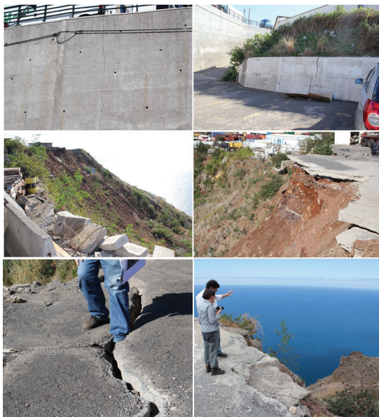
Fig. 15 - Evidências da forte instabilidade da plataforma, zona envolvente e parte frontal do aterro. (Fotos: Duarte Araújo, 2011 e 2012).
