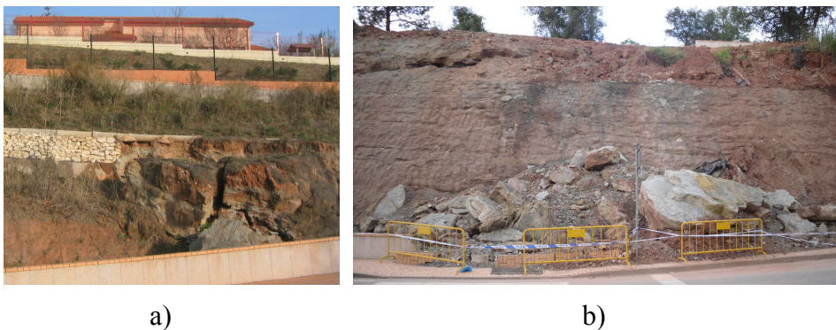
Figura 7. Deslizamentos planares de 2007 e de 2010 no talude Oeste da Escola do Areeiro. a) deslizamento do Inverno de 2007 na zona sul; b) deslizamento do Inverno de 2010 na zona norte.
