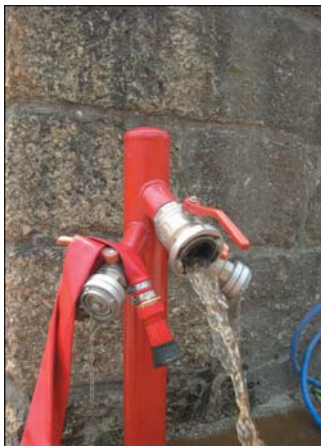
Fot. 10 - Rede de água sem pressão, o que deixa a boca de incêndio sem qualquer utilidade prática.
