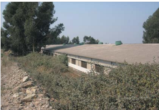
Rot. 7 - Pequena exploração industrial confinante com área florestal sem faixa de proteção exterior.
