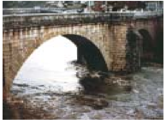
Fot. 14 - Pilares da Ponte de São Gonçalo durante a cheia de 1995.
