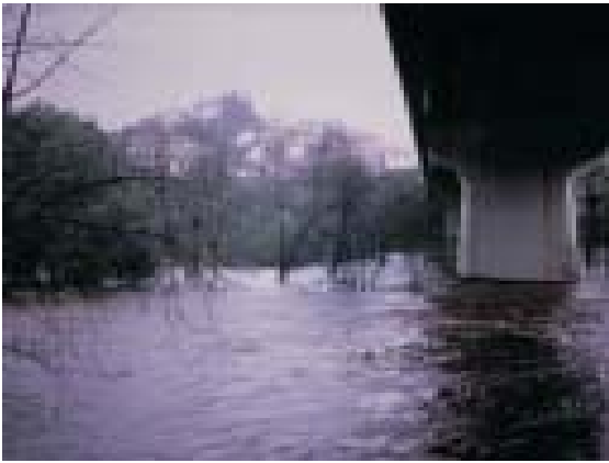
Fot. 13 - Pilares da Ponte Nova durante a cheia de 2001.
