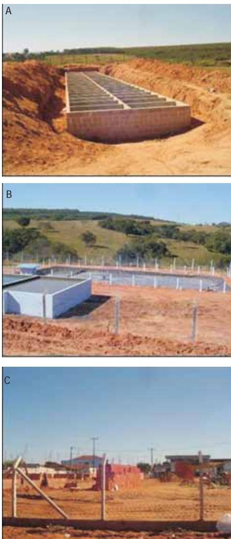
Fot. 5 - Obras civis em áreas de risco, sendo A: cemitério; B: estação de tratamento de esgoto; C: escola.
