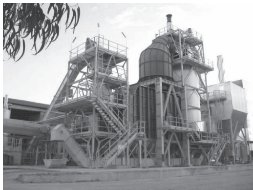
Figura 7 – Vista da câmara de combustão na unidade industrial de prensados de madeira da Nazaré (fonte: Seita e outros, 2009)
