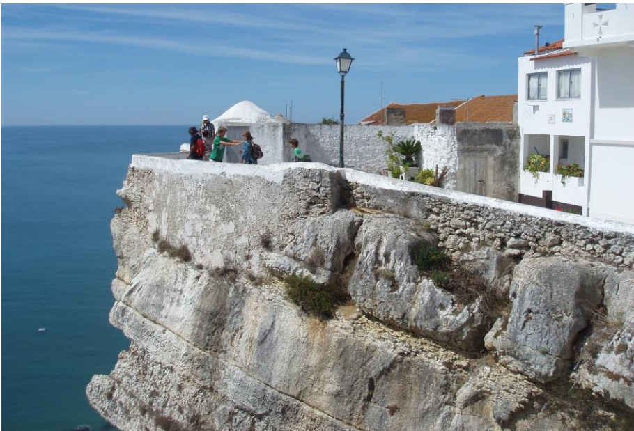
Fot. 10 - Sítio da Nazaré (2012). Alguma consolidação com cimento para prevenção de queda de pequenos blocos e proteção de habitantes e turistas.
