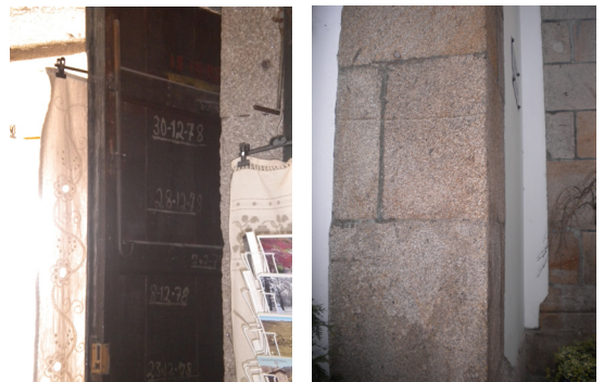
Fots. 6 e 7 - Marcas de inundações em edifícios do centro histórico de Ponte de Lima. Fonte: MARQUES, 2012.
