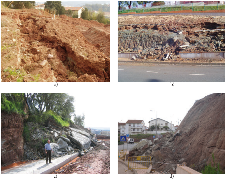
Fig. 1 – Aspeto de algumas das instabilizações ocorridas no Areiro. a) Estrada a nascente da escola do Areiro, em Março 2004; b) Talude da escola do Areiro, em Dezembro de 2005; c) Urbanização da Quinta do Areiro, em Março de 2006; d) Rotunda do Areiro, em Abril de 2010.
