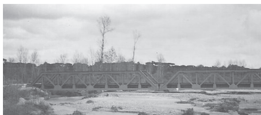
Fotografia 7 Assoreamento do ribeiro dos Milagres, junto à ponte da via-ferrea. Fonte: Mário GALLO, 1942a.
