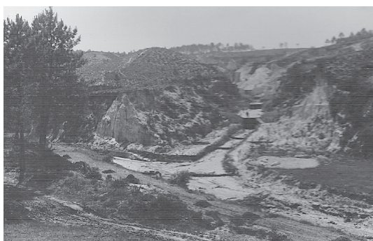
Fotografia 13 Aspeto das obras de correção do ribeiro das Figueiras, em 1936. Fonte: Mário GALLO, 1942a.
