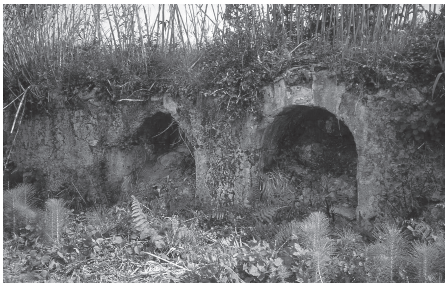
Fig. 15 – Alcobaça. Abadia Cisterciense. Troço aéreo de adução de água potável (destruído nos finais da 1ª década de 2000). Fotog. Virgolino Jorge
