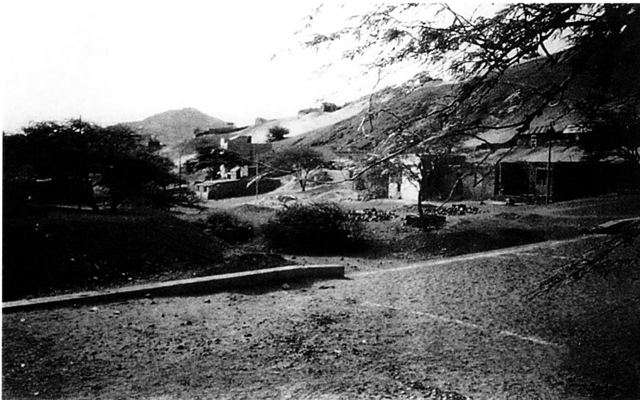
Fot. 45 - Mindelo - mini-barragem de correcção torrencial entulhada e casas construídas no talvegue da ribeira.
