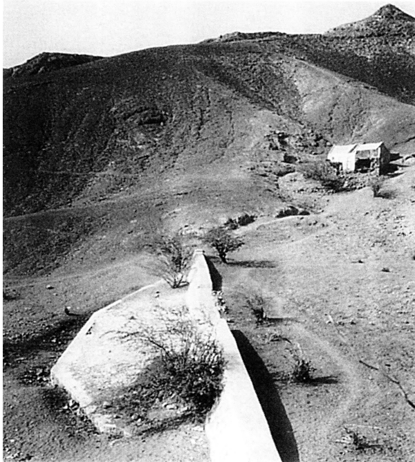
Fot. 44 - Mindelo - mini-barragem de correcção torrencial semi-entulhada.
