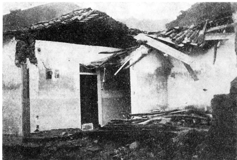
Fot. 32 - Casa parcialmente destruída pelas águas no Faial da Terra (Rua dos Alamos). Localização: Ver Fig. 28-5.
