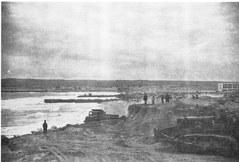
Fot. 7 - Obras de entulhamento da enseada que ameaçava a povoação da Cova.
