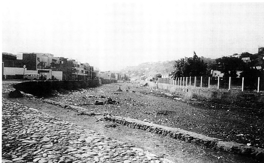
Fot. 42 - Praia — leito de ribeira com blocos, calhaus e lixo com muro-dique semi-destruído
