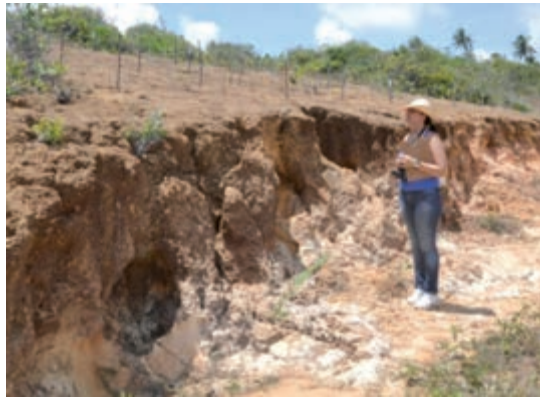
Fig. 9 – Encostas onde estão sendo introduzidas mudas de plantas nativas, a fim de minimizar os processos erosivos.
